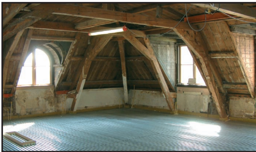
Mise en oeuvre de tôles profilées en queue d'aronde Duoform (cfr. page-data) à l'occasion d'une opération de rénovation totale
