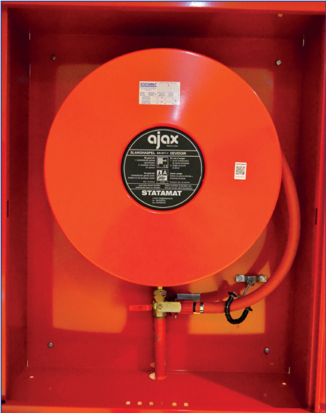
HASPELS, KASTEN, EN HYDRANTEN
